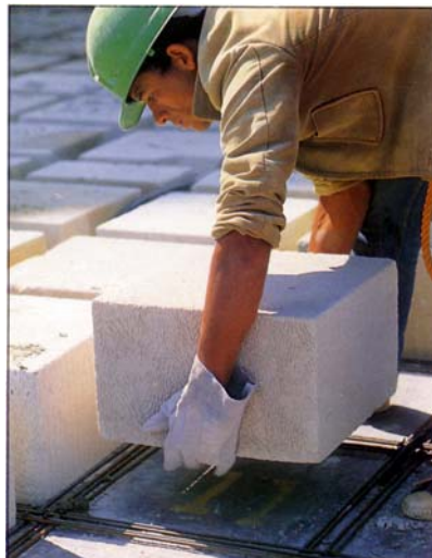
Figura 26 – Laje nervurada moldada no local com bloco de concreto celular autoclavado (SICA, s/d).
