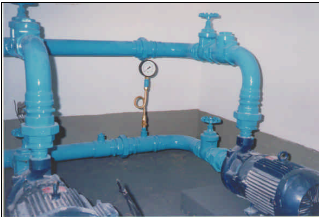
Foto 7 - Estação Elevatória de Água Tratada
